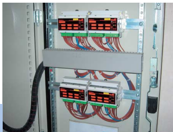
Schaltgeräte für die Rauchabzugsanlage.
