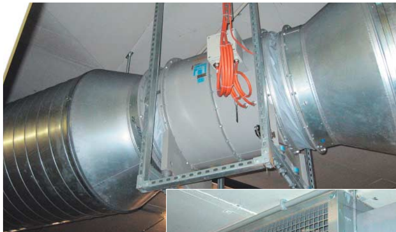
Rauchgasventilator mit einer Förderleistung von 60000 m 3 /h.
