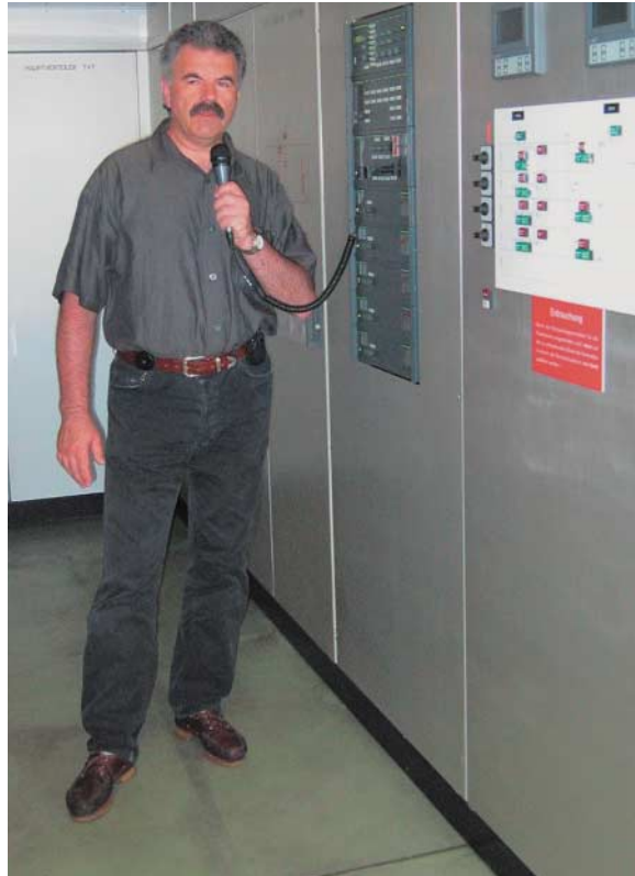
Peter Schurter, Leiter Parkhäuser Basel-Stadt, vor dem Feuerwehrtableau mit Brandabschnittsschaltung und Durchsageanlage.
