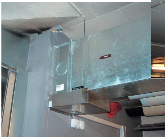
Brandschutzklappe mit Vandalensicherem Gehäuse über dem Antriebsmotor.
